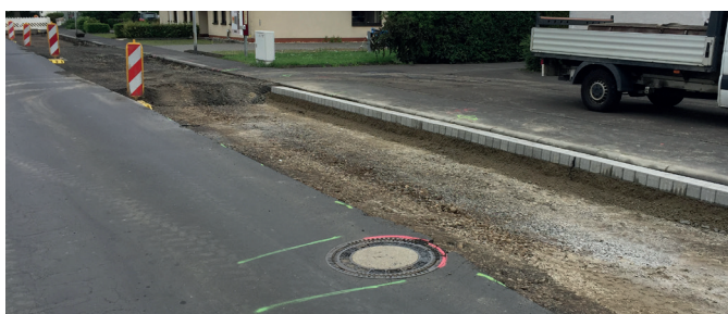
Schade voor de reparatie
