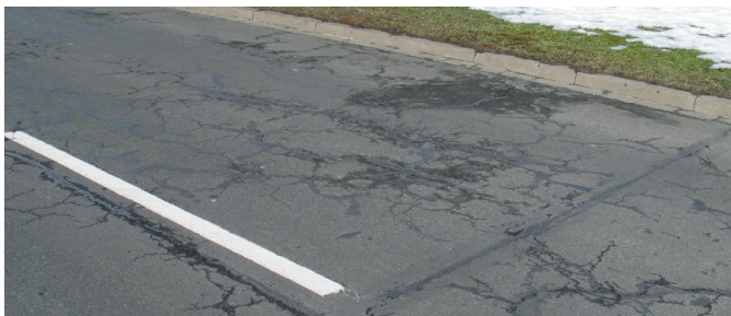
Schade voor de reparatie
